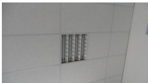
Figura 4.20 - Particolare dei corpi illuminanti ubicati nell'edificio- fluorescente 4x18W
