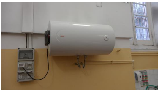
Figura 4.19 - Bollitore elettrico con accumulo – scuola media
