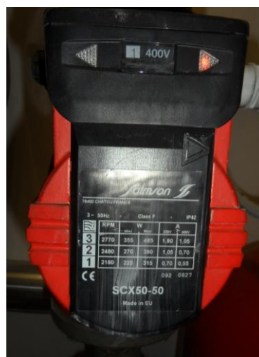
Figura 4.18 - Particolare pompa anticondensa del generatore di calore
