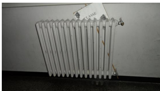
Figura 4.13 – Particolare – radiatore in ghisa – scuola elementare
