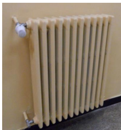
Figura 4.14 - Particolare -- radiatore in ghisa – scuola media
