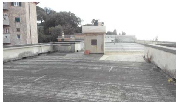
Figura 4.6 – Copertura non coibentata edificio
