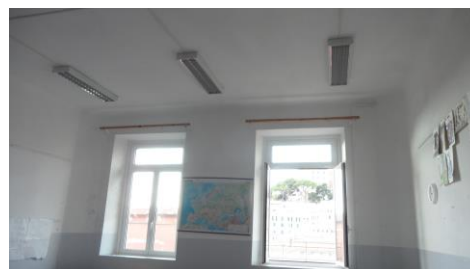
Figura 4.21 - Particolare dei corpi illuminanti ubicati nell'edificio – fluorescente 2x36W
